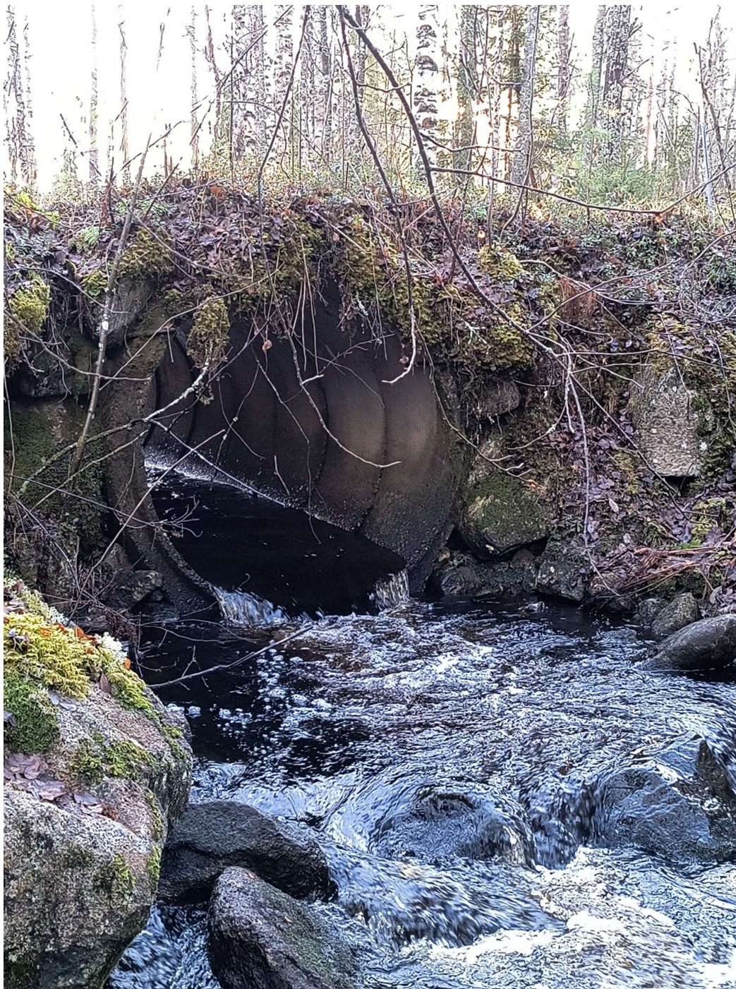
Kuva 12. Betonirumpu liian korkealla, toimii nyt osittaisena vaellusesteenä kohteella 13.
